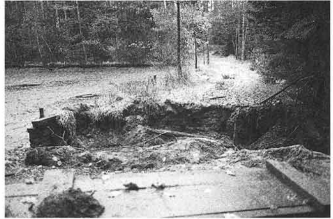
Abb. 23: Dambruch an einem zu Fischteichen aufgestauten Nebenbach der Lutter (1992).
