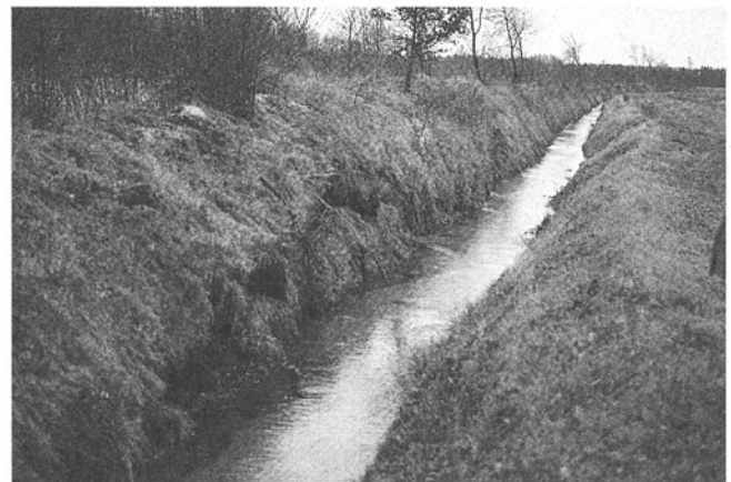
Abb. 13: Böschungsrutschung nach häufiger Grundräumung, die zu einer sukzessiven Eintiefung des Gewässers mit immer steileren Böschungen führt.
