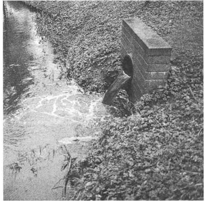
Abb. 20: Auslauf einer dörflichen Straßenentwässerung während eines Regenschauers (Ortslage im Einzugsgebiet von Lachte und Lutter, 1993).
