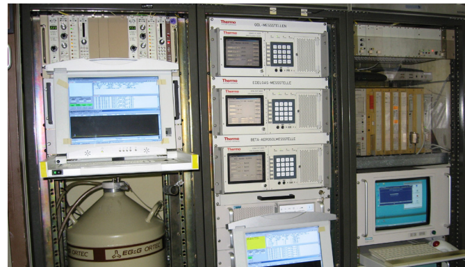
KFÜ-Raum mit Messgeräten zur kontinuierlichen Überwachung
