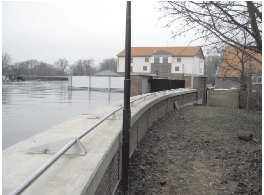
Die Hochwasserschutzwand in Hitzacker schützt die Stadt vor den Fluten.
