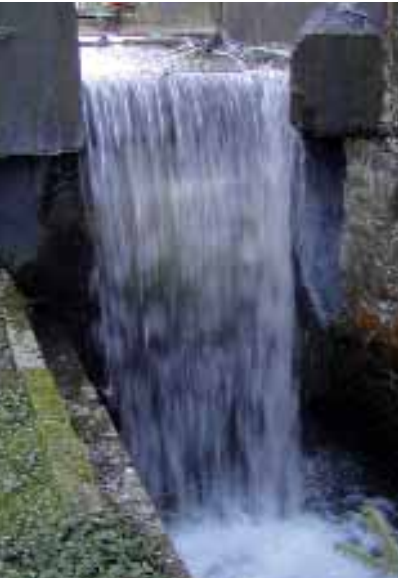
Querbauwerke wie hier am Hillebach im Einzugsgebiet der Weser behindern die Durchgängigkeit der Gewässer. Sie werden als Hilfsparameter zur ökologischen Bewertung herangezogen.
