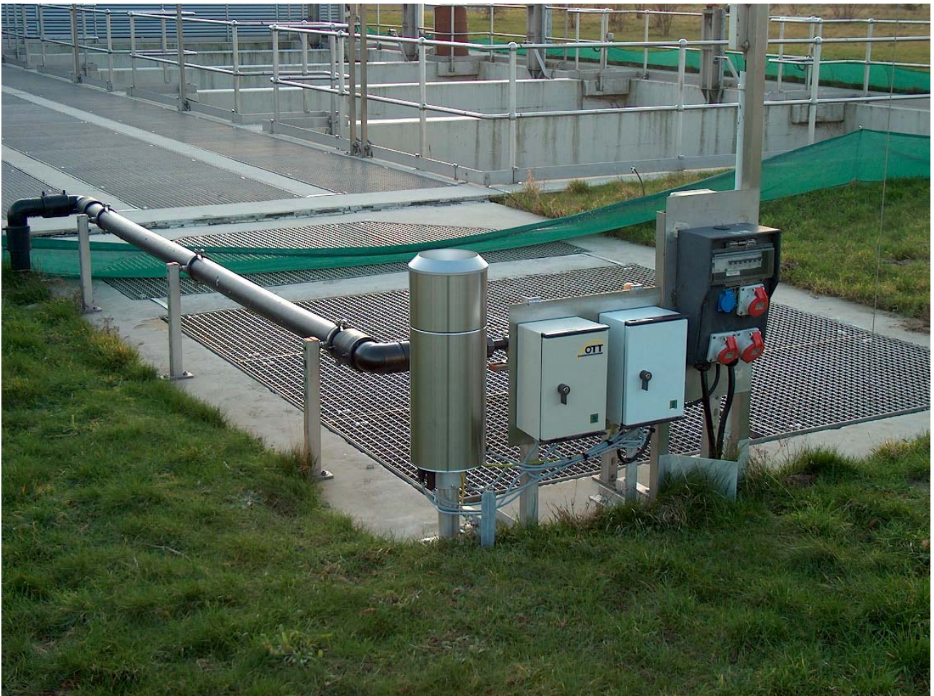
Niederschlagsmesser Kläranlage Salzgitter Quelle: NLWKN
