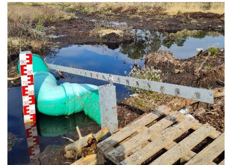
Regelbare Überlaufkonstruktion; Foto: J. Fahning
