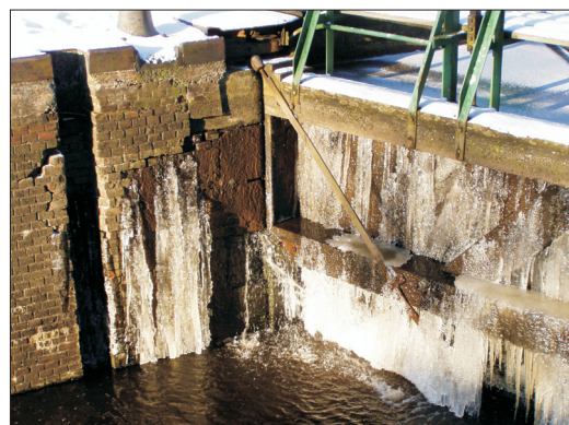
Eisbildung durch Wasserwegigkeit
