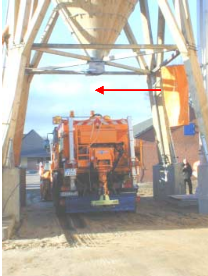
Salzsilo mit schwenkbarer Vorrichtung zur Verhinderung von Verwehungen beim Abfüllen ( Die erforderliche Dichtfläche muss noch hergestellt werden )
