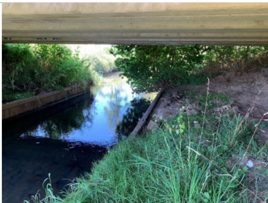
Abb. 20: Brücke Tannenbruch; Laufweg beidseitig zugewachsen (D5; Station 13+285; 08/2022)
