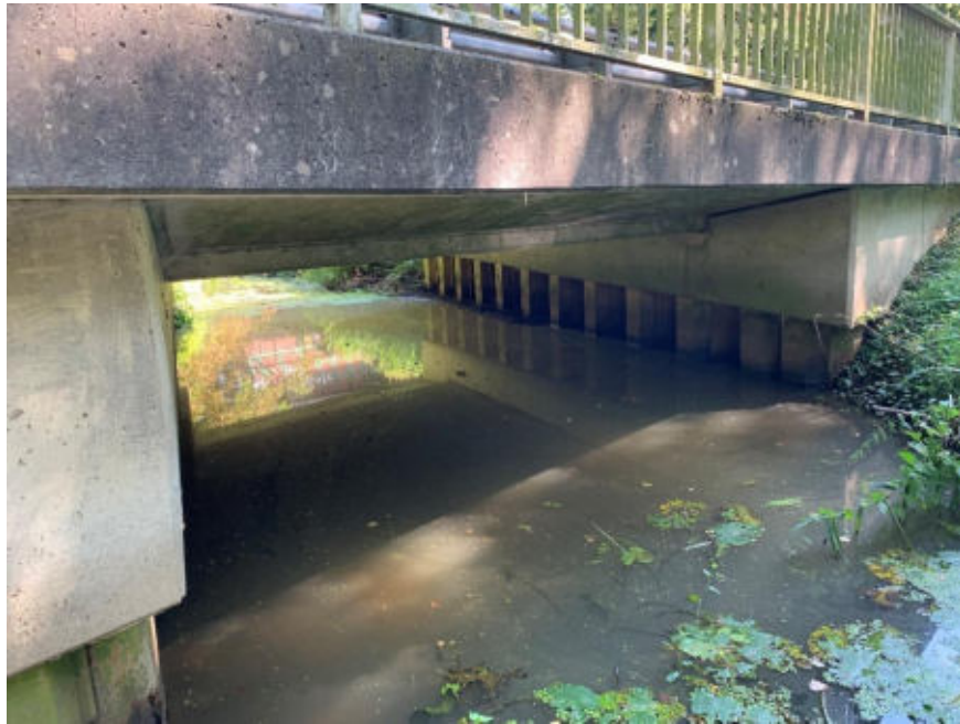
Abb. 17: Brücke unter der K48 (D11; Station 23+710; 08/2022); keine Berme
