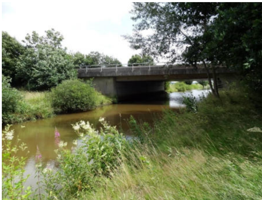
Abb. 21: Brücke BAB A27 103 (D4; Sta- tion 8+233); Berme un- geeignet?
