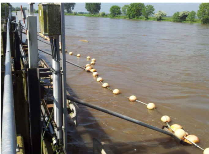
Abbildung 7: Elektrische Fischeicheanlage, Quelle: Statkraft Markets GmbH
