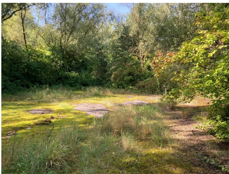
Abbildung 12: Stark verwitterter Rest einer Asphaltfläche im Waldgebiet des ehemaligen Klärteich 1.
