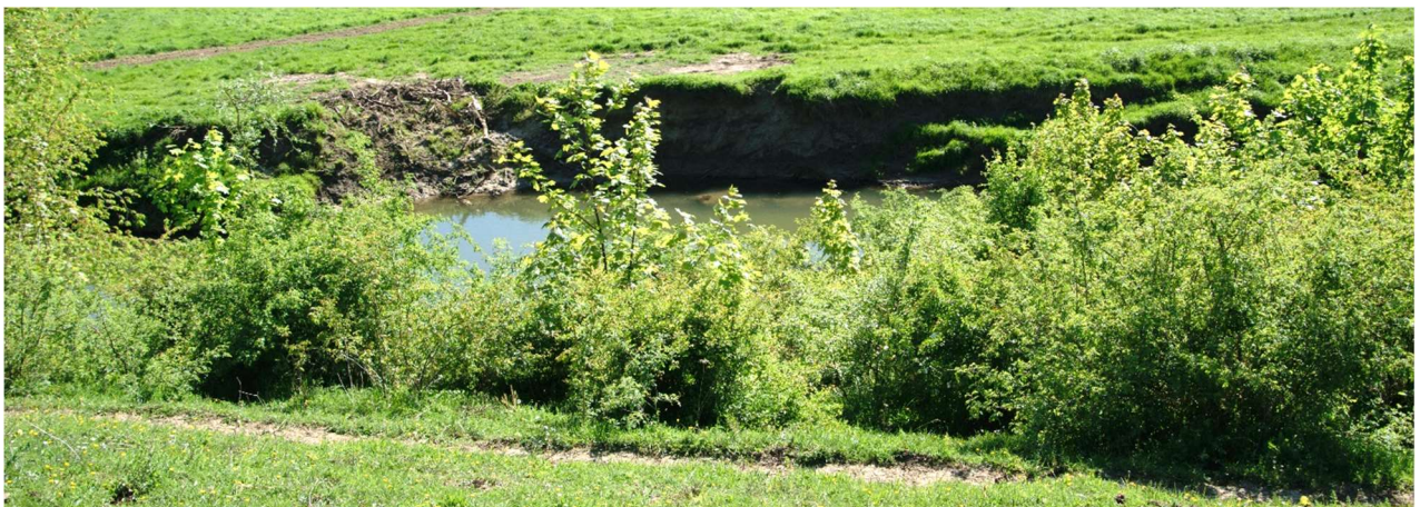
Foto 12: Abbruchkante an der Innerste auf Höhe des roten Steins
