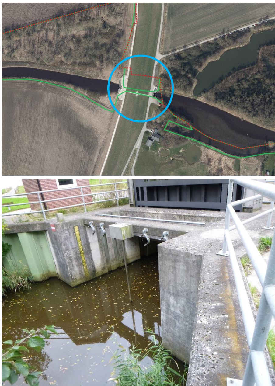
Abb. 13: Sielbauwerk für den Aschwardener Flutgraben im Landesschutzdeich Luftbild: Standort des Fotos (C. Habenicht; September 2021): blauer Kreis; rot: Kreisgrenze; grün: Grenze des FFH-Gebietes 187
