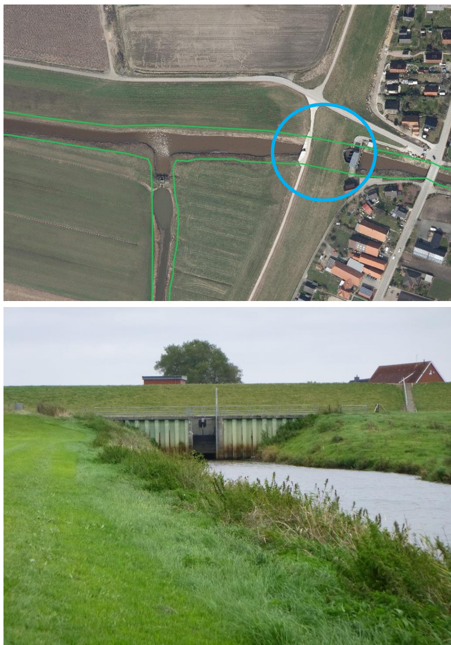
Abb. 15: Sielbauwerk für das Hinnebecker Fleth im Landesschutzdeich
