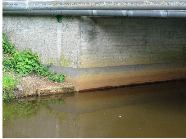
Abbildung 13: Brückenunterführungen mit glatten Wänden ohne Uferstreifen oder Bermen werden vom Fischotter gemieden (17.05.2021, NEUMANN)
