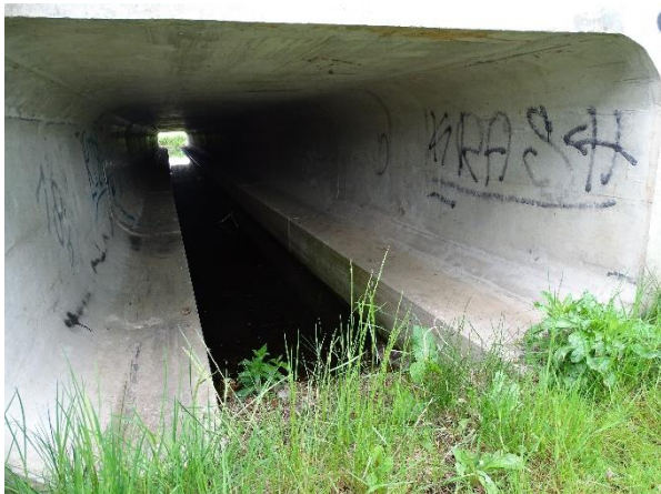
Abbildung 14: Der im Jahr 2012 erbaute Fischottertunnel bei „Kutscher Behrens“ ist nur auf einer Seite mit der Unteren Wörpe verbunden und verfehlt damit seine Funktion (17.05.2021, NEUMANN)
