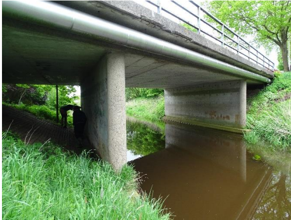
Abbildung 7: Die Wörpe Brücke Mühlendamm in Wilstedtermoor ist für Fischotter baubedingt querungssicher (17.05.2021, NEUMANN)
