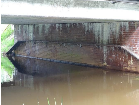
Abbildung 11: Brücke Speckmannstraße; ein Steg leitet den Fischotter durch die Unterführung (17.05.2021, NEUMANN)
