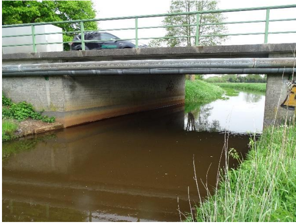
Abbildung 12: An der Wörpe-Brücke „Heidberger Straße“ besteht Handlungsbedarf, da diese für den Fischotter nicht passierbar ist (17.05.2021, NEUMANN)
