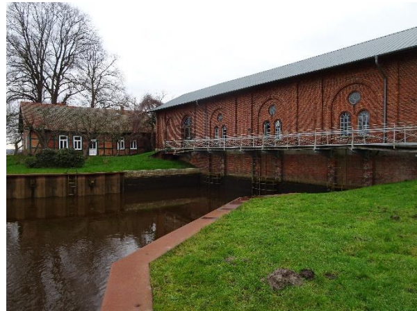
Abbildung 4: Auch das Schöpfwerk beim Maschinenfleet stellt ein Querbauwerk dar, das die ökologische Durchgängigkeit beeinträchtigt (14.01.2021, BÖRGMANN)
