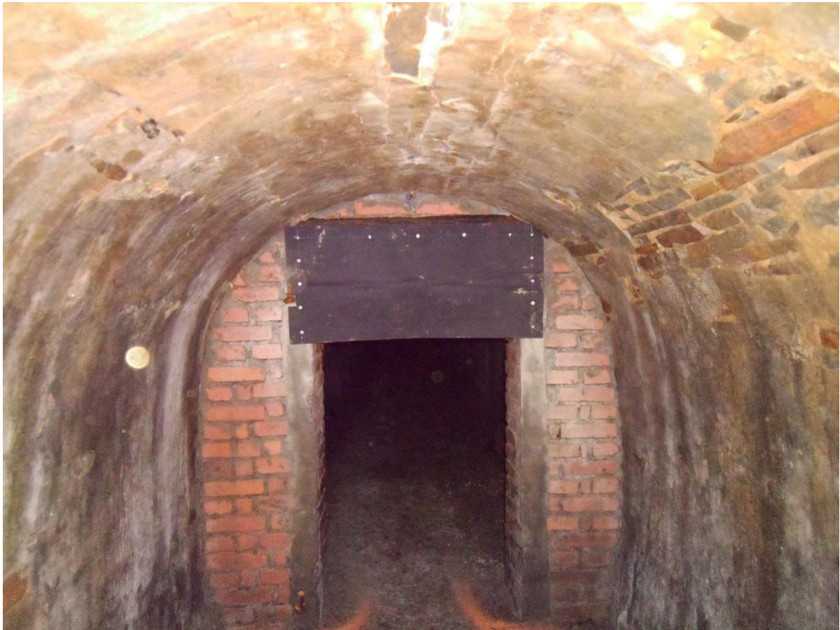
Anhang 2: An einem gemauerten Durchlass angebrachte Kunststoffmatte zur Reduzierung der deckennahen Luftströmung und Schaffung/Erhaltung statischerer und wärmerer mikroklimatischer Verhältnisse im Deckenbereich
