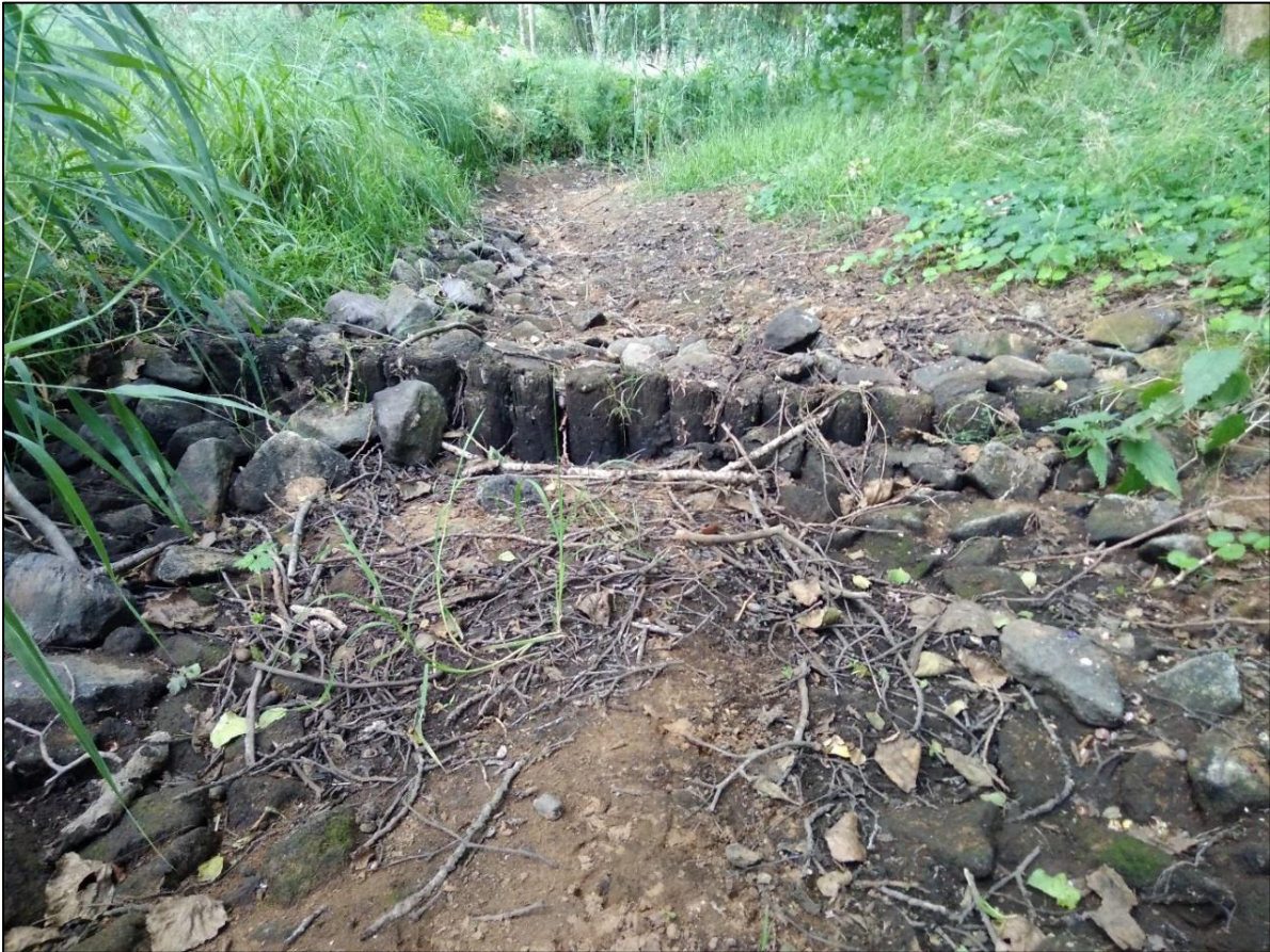
Abb. 5: Sohlabsturz am Schillingmanngraben (Juli 2019)
