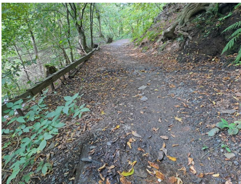
Abb. 5: Notwendigkeit einer Instandsetzung des Wanderweges.
