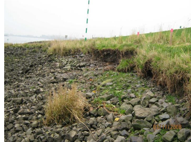
Uferabbruch im Bereich des Harburger Deichverbandes
