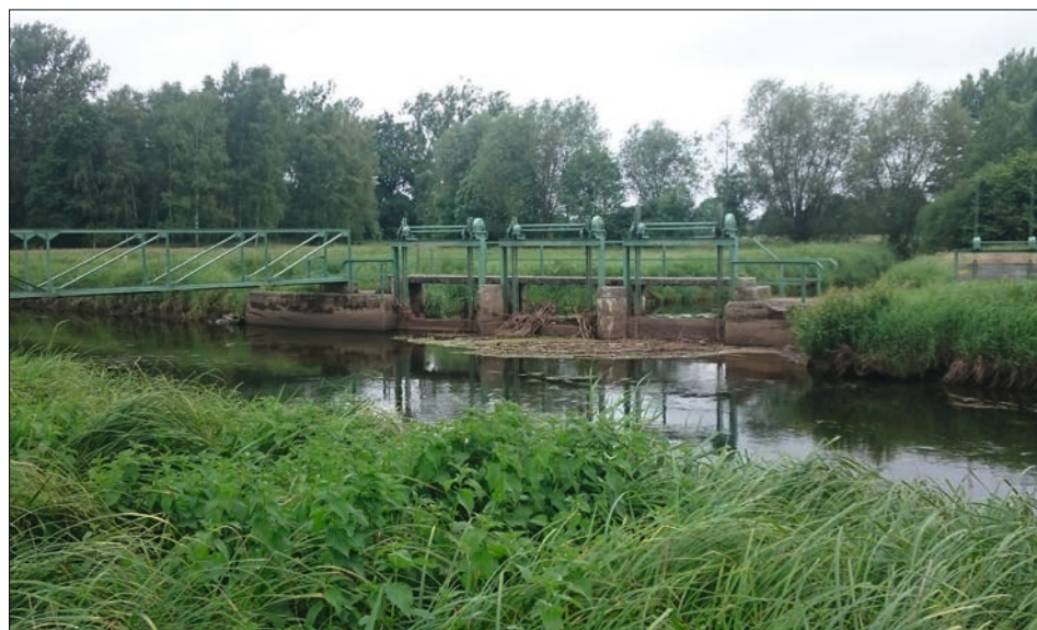
Abschlagsbauwerk in den alten Allerlauf
