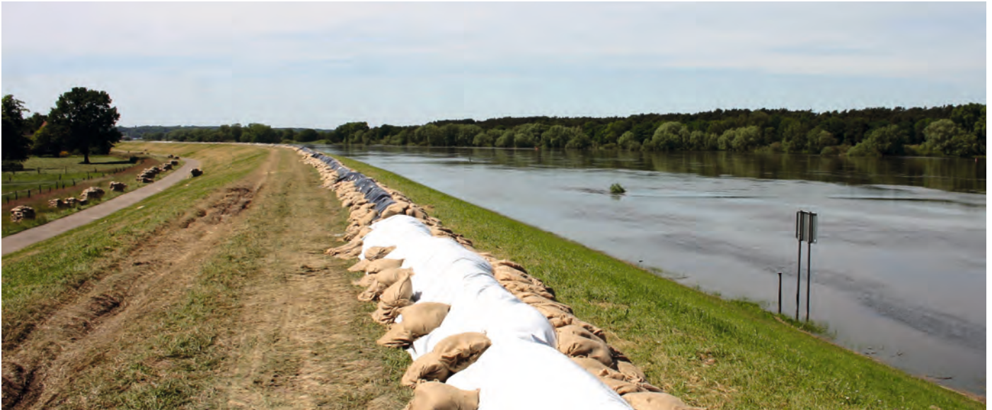
Beschädigter Elbedeich bei Bleckede nach der Flut: Deichkronen und Deichböschungen waren durch das Befahren mit schwerem Gerät und dem Einbau von Sandsäcken immens beansprucht.
