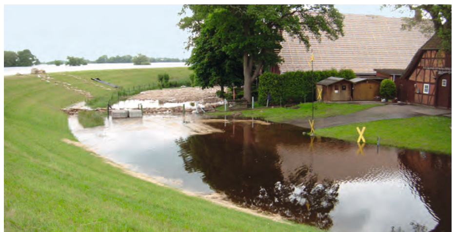
Beschädigter Elbedeich bei Alt-Wendischthun: Qualmwasser auf der Binnenseite und Sandsäcke zur Deichverteidigung hinterlassen Schäden.
