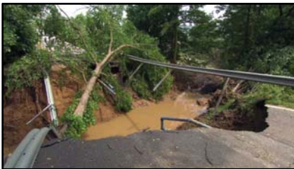
Unterspülte Landstraße 79 bei Leimersdorf, Copyright: SWR
