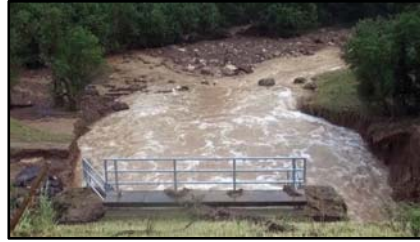
Beschädigtes RRB Nierendorf, Copyright: SWR
