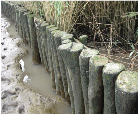
Foto 5: Seepocken ( Amphibalanus improvisus ) an Pfählen in Höhe des Wasserspiegels
