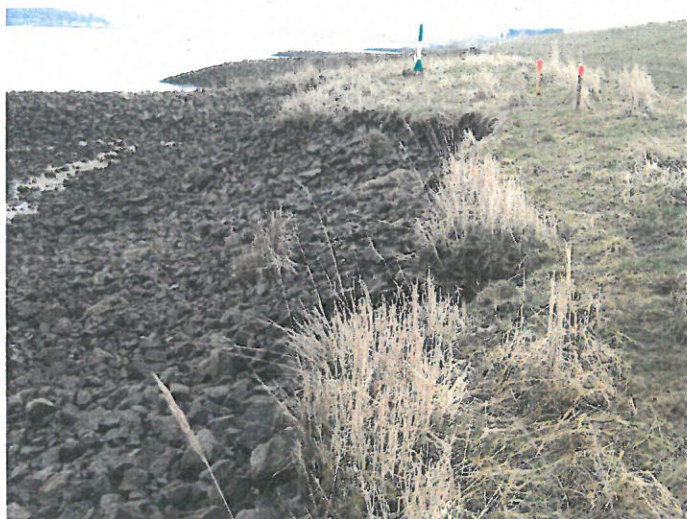
Foto1: Deckwerksschäden;HDV02, Abschnitt 1; 2009; Foto: NLWKN
