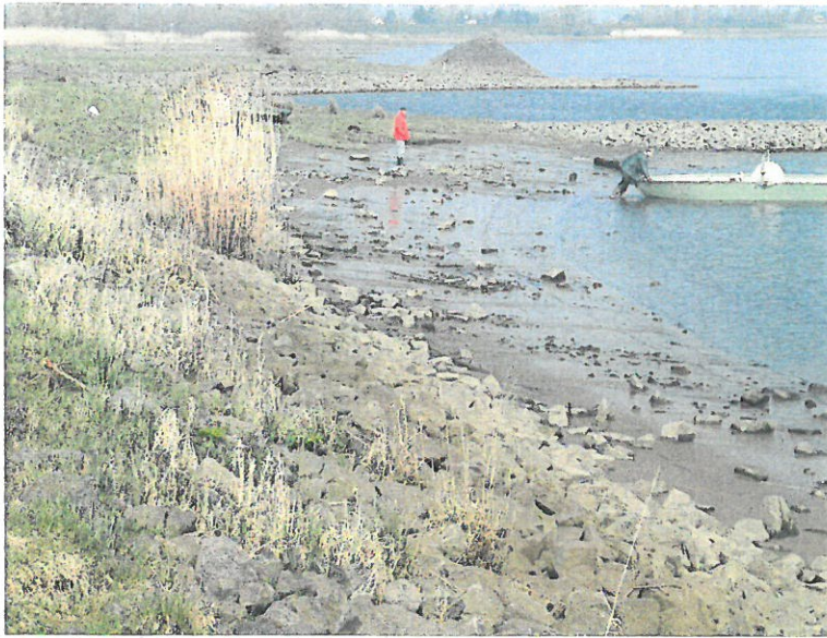
Foto3: Deckwerksschäden; DVN02, Abschnitt 1; 2006; Foto: NLWKN
