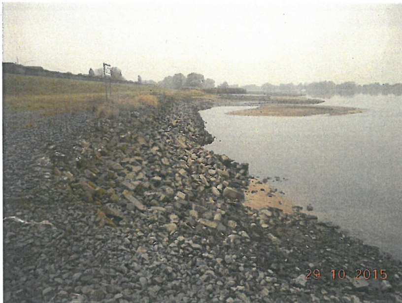
Foto4: Deckwerksschäden; DVN03, Abschnitt1; 2015; Foto: NLWKN
