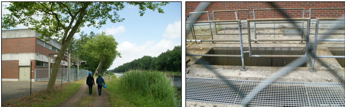
Abb. 3: Entnahmebauwerk (Pumpwerk) am Dortmund-Ems-Kanal mit Rechananlage eigene Aufnahmen vom 24.06.2015
