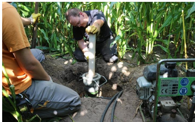
Abb. 2: Rückbau einer Grundwassermessstelle mittels Herausziehen der Rohre aus dem Untergrund am Standort Markhausen in einem Maisfeld
