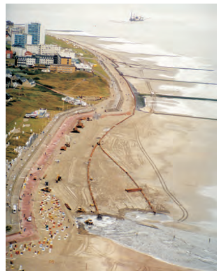
Abb. 5: Westkopf der Insel Norderney mit der Spülleitung der Strandaufspülung 2000
