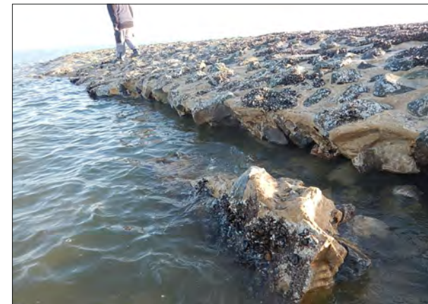
Abb. 3: Schadstelle an der Buhne E1
