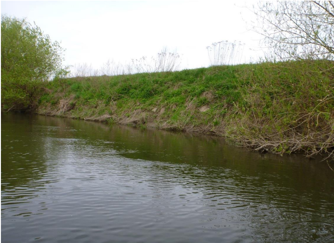
Abb. 3: Typische strukturelle Defizite an der Leine: Vertieftest Profil, Steile befestigte Uferböschung (hier überwachsene Steinpackung).
